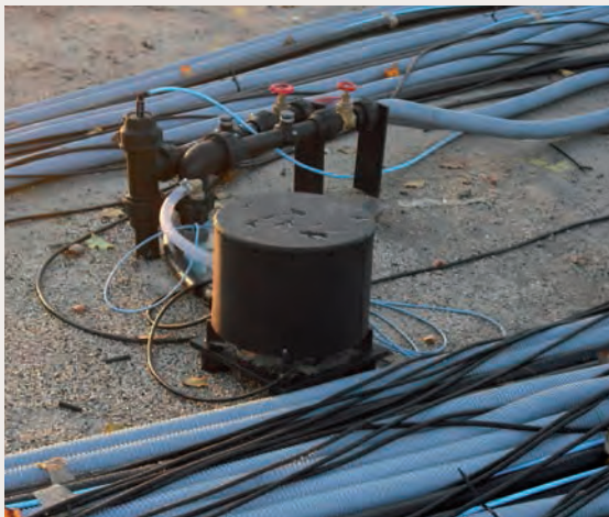
Particolare impianto di risanamento in situ (Soil Vapour Extraction, Air sparging, Pump&amp;Treat)
